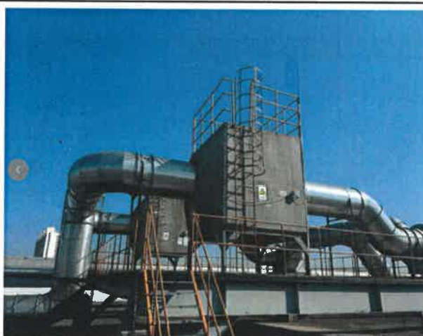
有机废气处理设施
