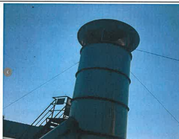
有机废气处理设施出口
